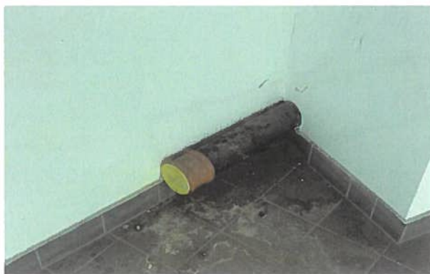
csatornabekötés darálós WC-hez
